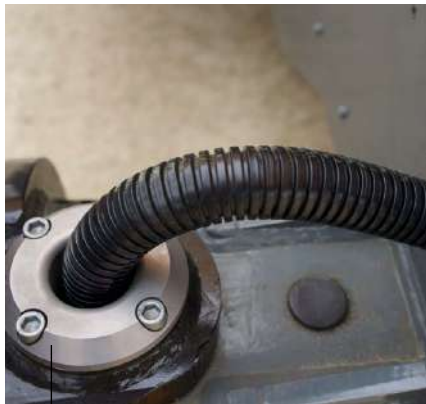
Excelente protección de los cables eléctricos más expuestos
